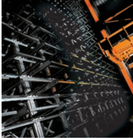
Moderner Stahlbau inklusive: UNIGRIP Regalanlage.
