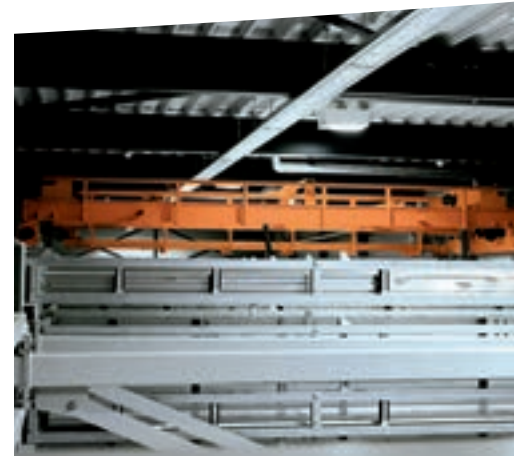
Überfahrlager für kundenseitige Gestelle in der Fensterproduktion.
